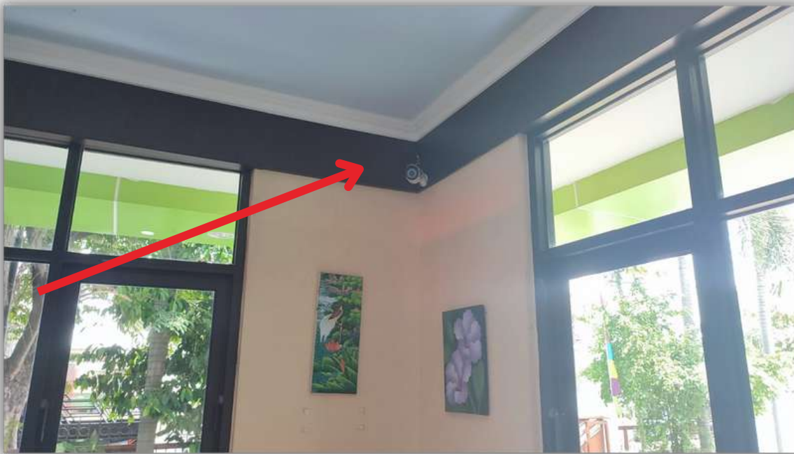
CCTV di ruang tunggu
